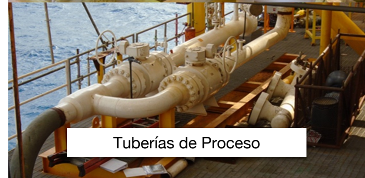
Tuberías de Proceso
